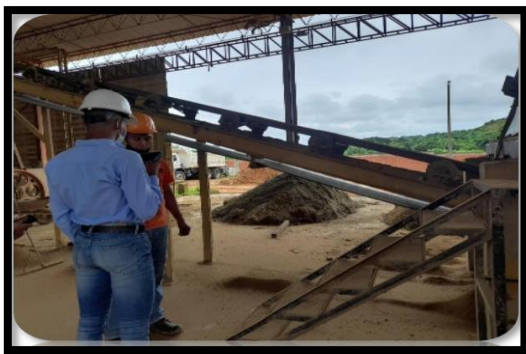
Figura 1. Proceso de Molienda.
