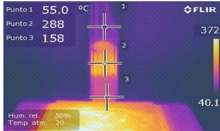
Fig. 6 perfil térmico en chimenea de una estufa
