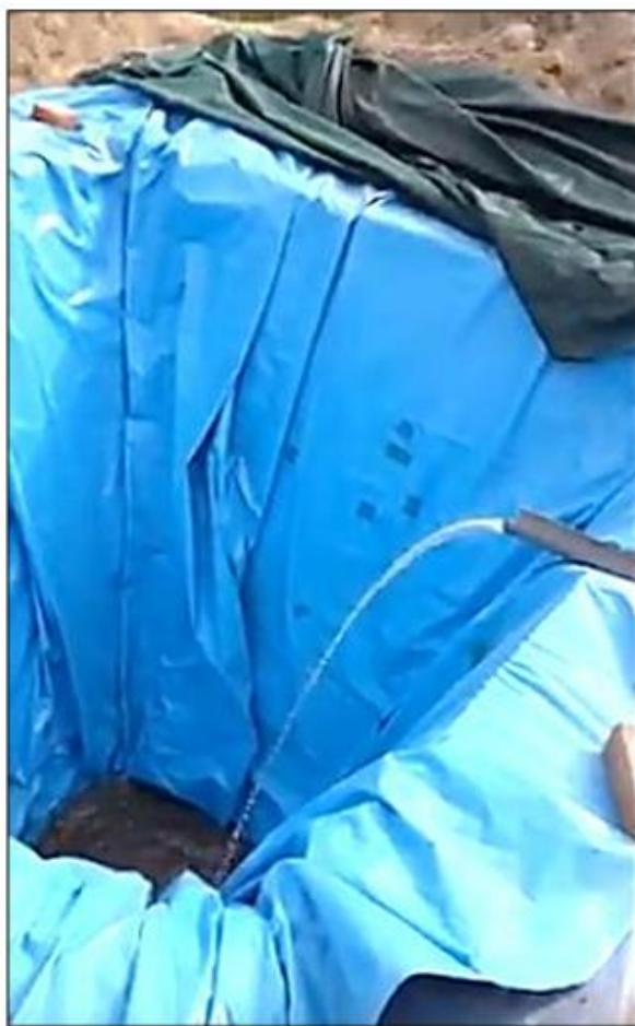
Figura 7. Agua residual, desembocando en la laguna anaerobia
